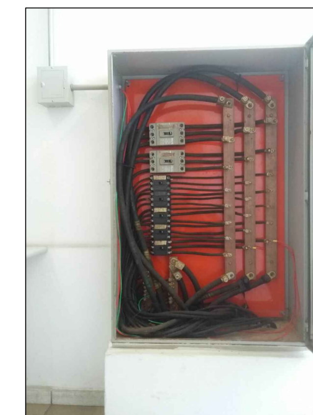
QUADRO GERAL DE BAIXA TENSÃO QGBT
