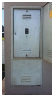
CAIXA COM DISJUNTOR
